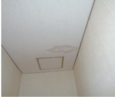
天井の雨漏り
