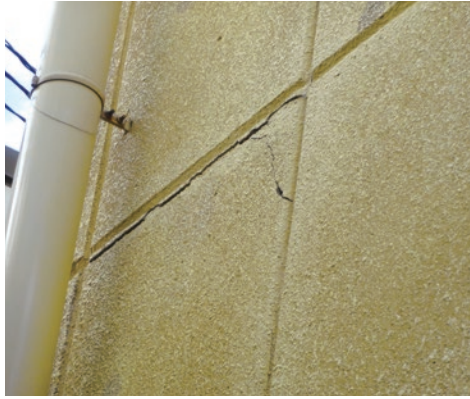
ALC壁にクラック
